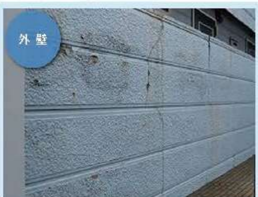
外壁 ひび割れやタイルが浮いて、外観の劣化とともに、雨水が建物内部に浸水!
